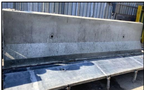
Рисунок III-2. Характерні пошкодження робочої (лицьової) поверхні блоків огороження типу Нью-Джерсі після зняття опалубки
