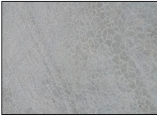
Рисунок II-2-1. Мікротріщини в цементобетонному покритті
