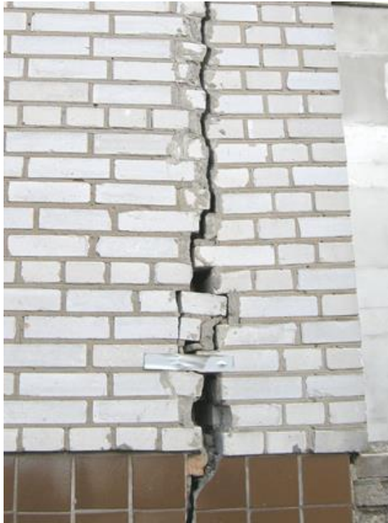
Рисунок П-7-4. Вертикальна тріщина в цегляній кладці огорожувальної конструкції
