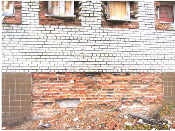
Рисунок II-7-1. Руйнування цегляної кладки огорожувальної конструкції навколо віконних отворів
